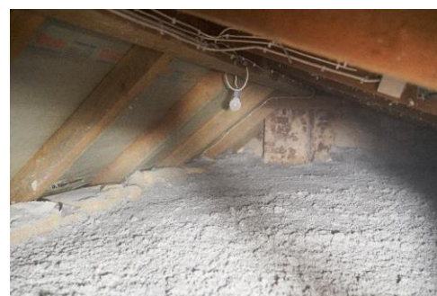
Abbildung 1: Dämmung der obersten Geschossdecke mit Klemmfilz aus Glaswolle (oben) und mit Zelluloseflocken (unten).
